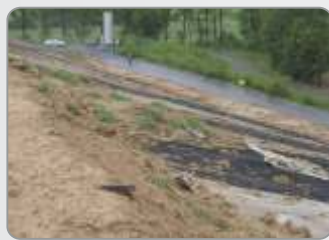
Cobertura de aterro sanitário após escorregamento sobre a geomembrana.
